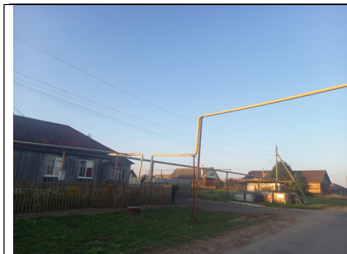
Газопровод по ул.Центральная
